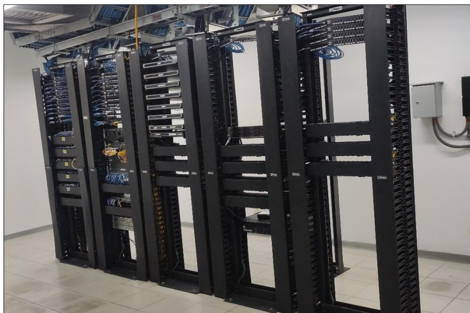
Figura 22. Racks de comunicaciones del Nodo A Cuarto de comunicaciones Principal del Proyecto Ituango
