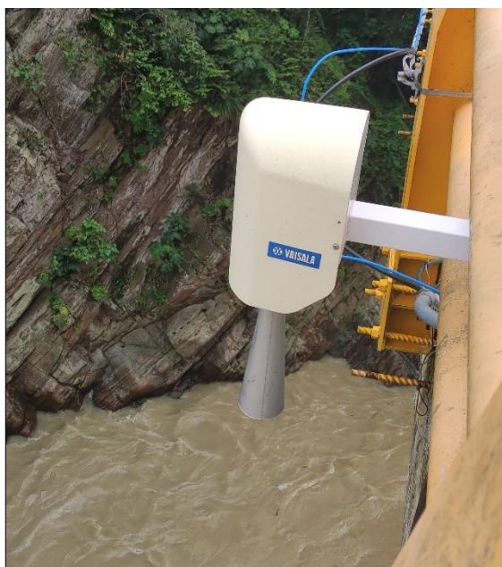
Figura 8. Sensor tipo Radar estación de Hidrometria
