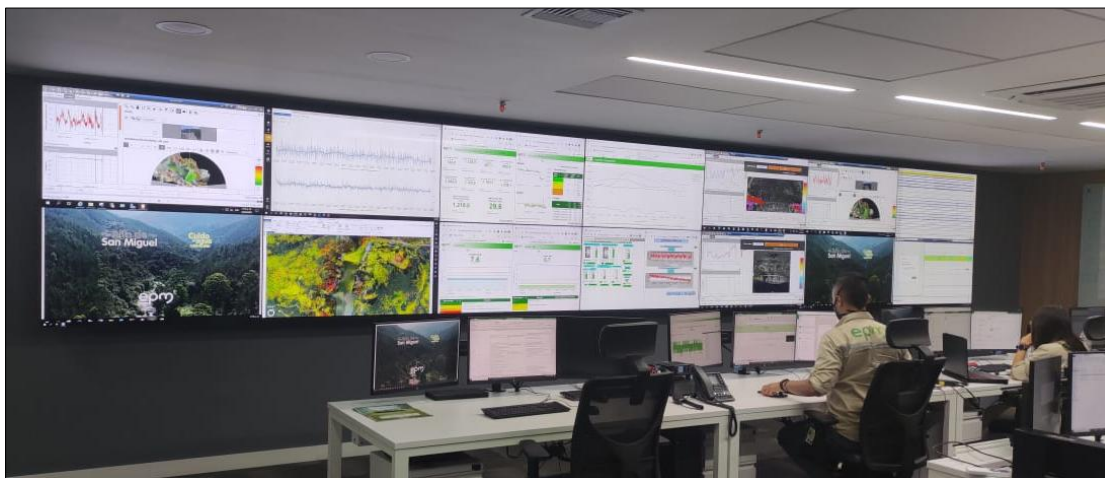
Figura 1. Sala de monitoreo técnico Proyecto Ituango EPM.
