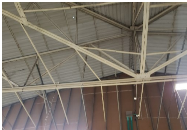
ilustración 140. Estructura cubierta original y teja actual trapezoidal.
