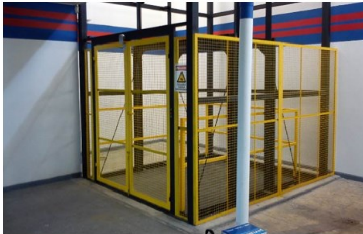
Figura 2-2 Cabina Ascensor de Carga.
