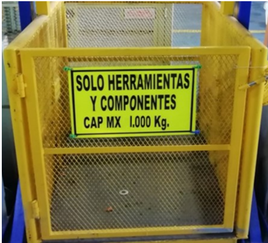
Figura 3-34. Canasto Ascensor de Carga.
