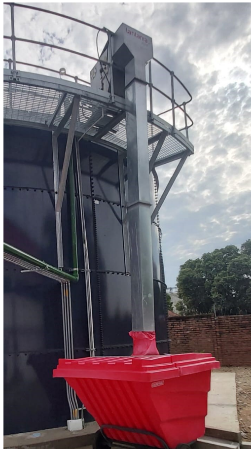
Figura 2-3 Ducto Cubico del Sistema de Alimentación
