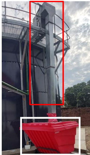
Figura 3-5 Lugar Establecido para la compactadora
