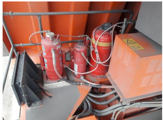
Figura 6. Supresor de incendio.
