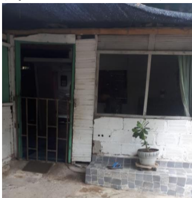
Figura 65, Estado de las viviendas, fuente propia.
