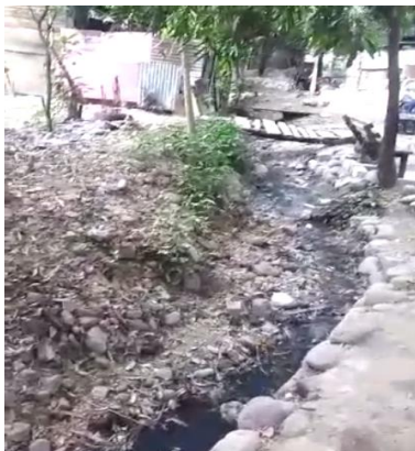
Figura 61, Evidencia de aguas negras atravesando el asentamiento; Fuente propia.
