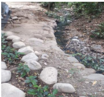
Figura 66, Los desechos de aguas negras van directos al rio las ceibas; Fuente propia.
