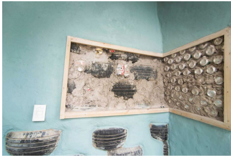
Figuara 4: Muro de la escuela pública sustentable en argentina. Fuente: (Fernando Calzada).
