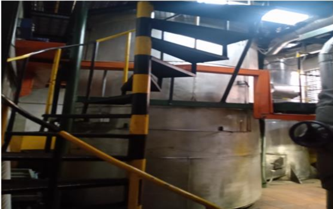
Figura 4-8: Caldera de aceite térmico.
