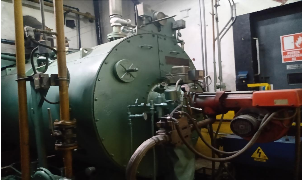
Figura 4-4: Caldera de vapor
