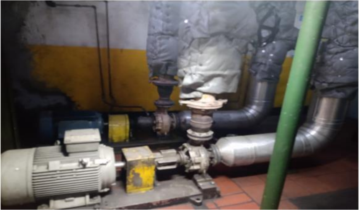
Figura 4-9: Bombas de recirculación de aceite.
