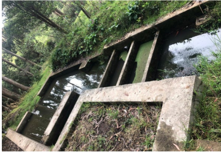
Anexo C. Desarenador de la sede. Fuente Propia
