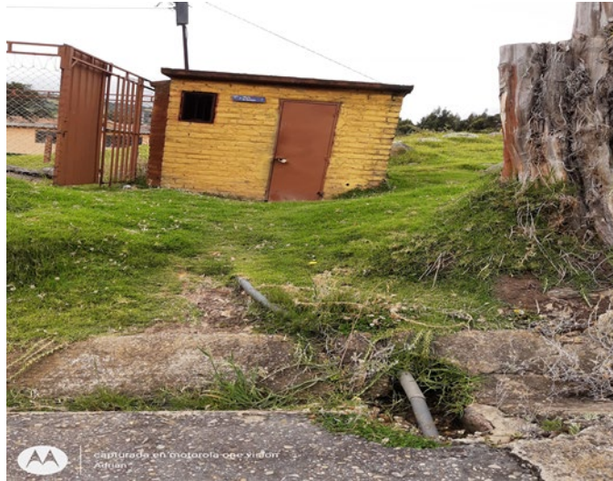
Anexo F. Cuarto de bombas de la sede. Fuente Propia
