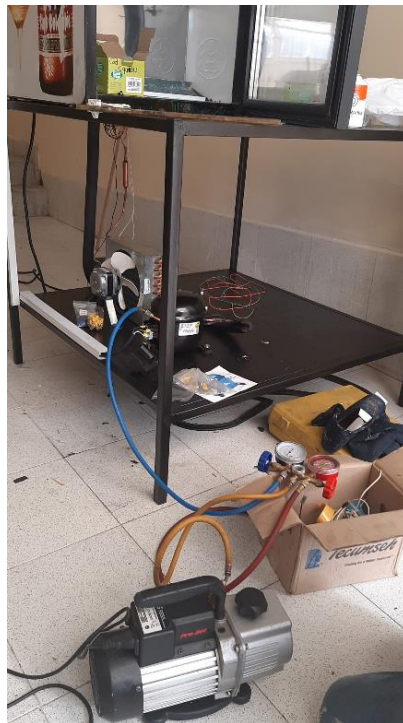
Figura 4-7: Proceso de vacío a circuito.
