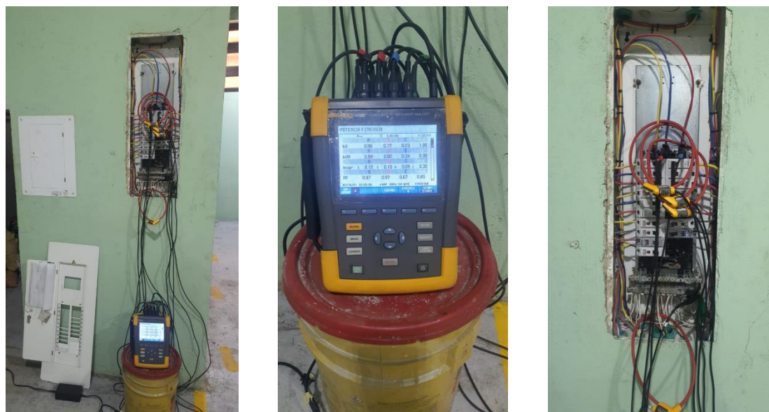
Ilustración 43: Evidencia de instalación de analizador de red. Fuente: Autores.
