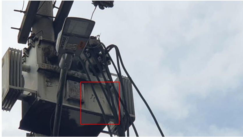
Ilustración 34: Transformador de uso general propiedad de Codensa de 45 kVa refrigerado en aceite. Fuente: Autores.
