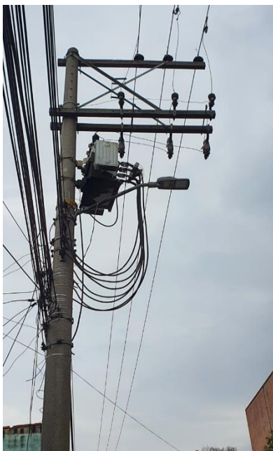
Ilustración 32: Centro de transformación urbano 8 - CTU 502. Fuente: Autores
