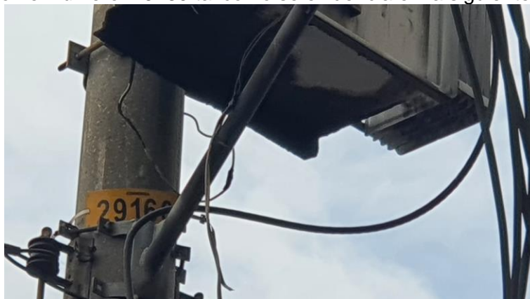
Ilustración 33: Centro de distribución propiedad de Codensa. Fuente: Autores.
