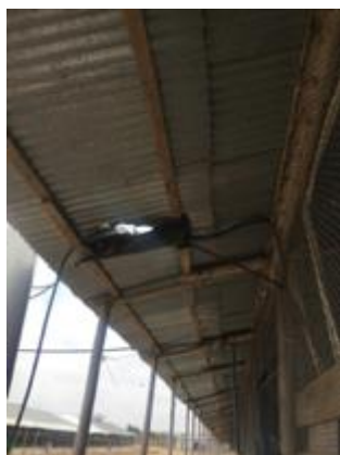
Evidencia# 8. Techo en mal estado módulo A granja Santa Elena.
