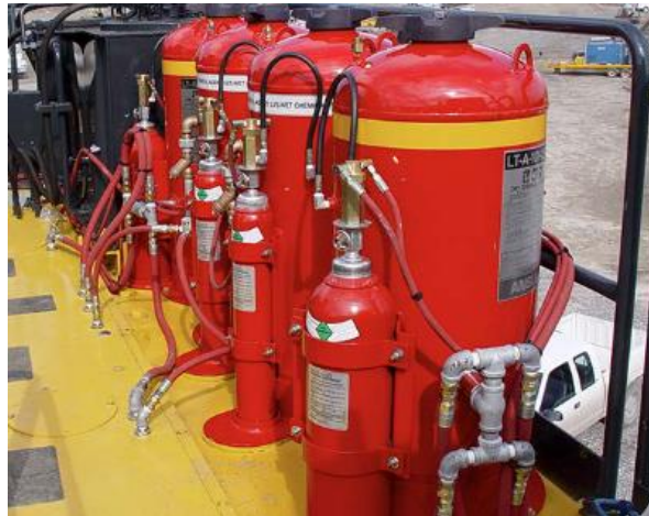
Figura 5.7. Sistemas de supresión de incendios (Ansul)
