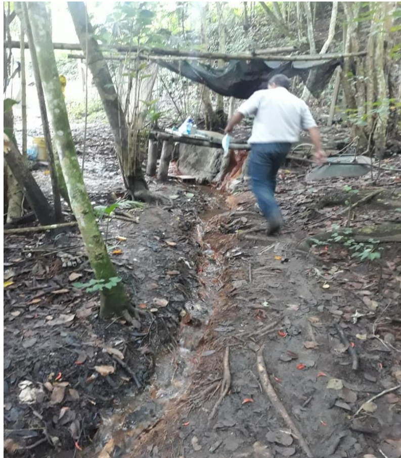
Figura 25. Sector captación Fuente. Propia
