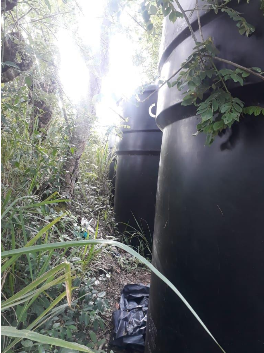
Figura 31. Tanques de almacenamiento. Fuente: propia.
