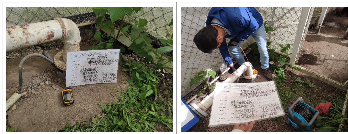
Figura 57. Monitoreo de nivel piezométrico. (E:1018340 N:1043930). Fuente: Elaboración propia, 2021.
