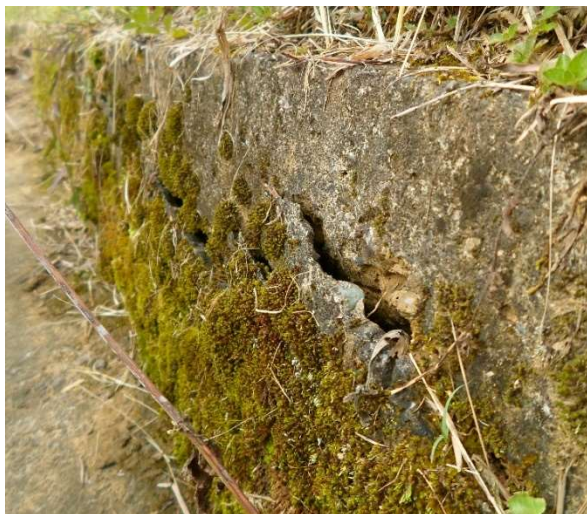
Foto 3. Fisuras o fallas en paredes de la zanja de coronación
