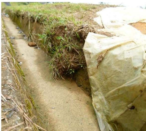
Foto 1. Reducción de sección de la zanja de coronación debido a presencia de material.
