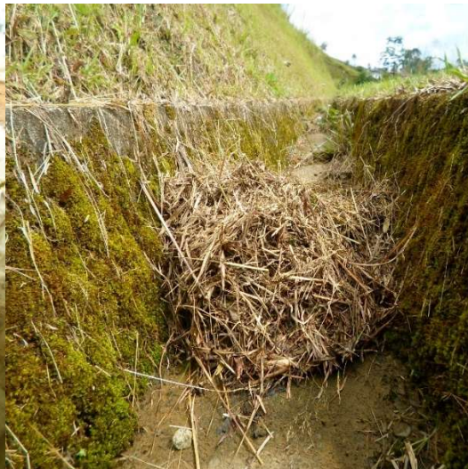
Foto 2. Obstrucción de zanja de coronación, con material vegetal.
