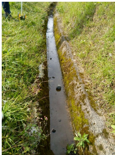
Foto 4. Estancamiento de agua lluvia debido a poca pendiente de las zanjas de coronación.
