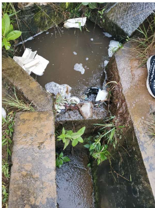
Foto 5. Acumulación de basuras en empalme entre las zanjas de coronación y canal.
