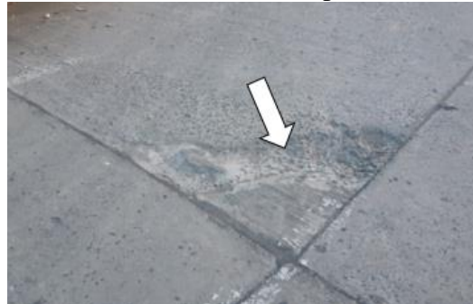
Figura 4. Localización perdida de capa superficial de rodadura en las losas de la vía del barrio Diamante etapa I
