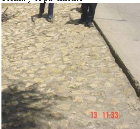
Figura 52. Vista típica Separación entre la berma y el pavimento
