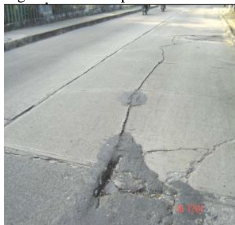
Figura 21. Vista típica Grietas en bloque
