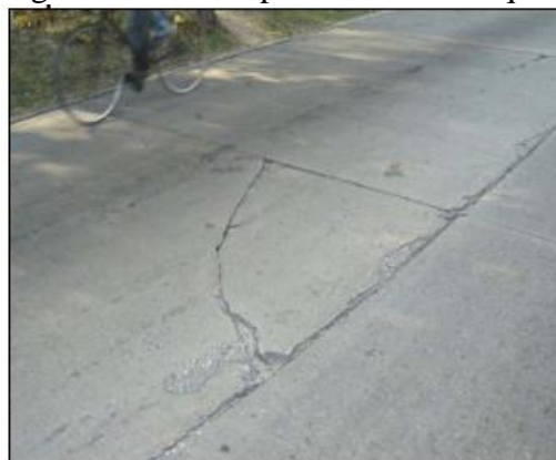
Figura 13. Vista típica Grieta de esquina
