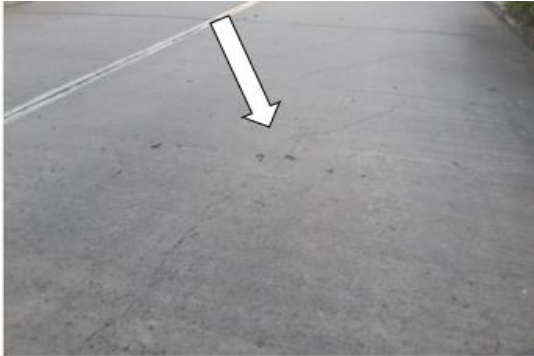
Figura 3. Localización fisuras en las losas de la vía del barrio Diamante etapa I
