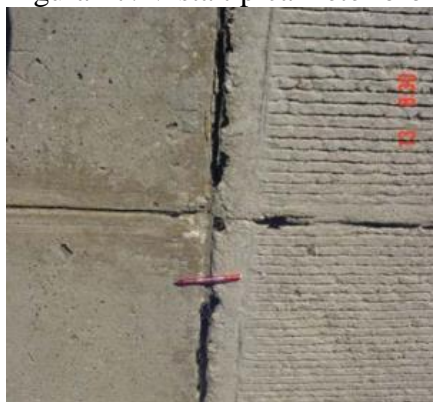
Figura 27. Vista típica Deterioro del sello
