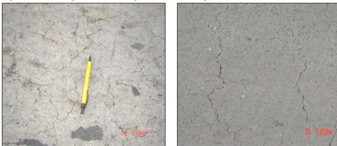
Figura 44. Vista típica Fisuración por retracción o tipo de malla
