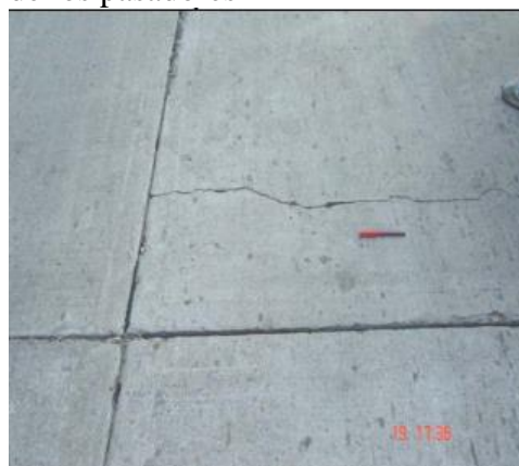
Figura 19. Vista típica Grietas en los extremos de los pasadores
