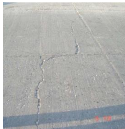
Figura 17. Vista típica Grietas transversales
