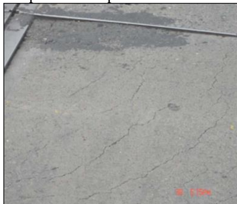
Figura 45. Vista típica Fisuración por ligeras de aparición temprana
