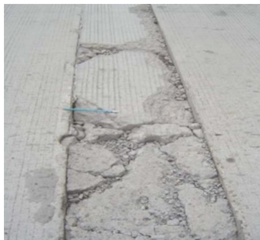
Figura 42. Vista típica Parches en asfalto y concreto
