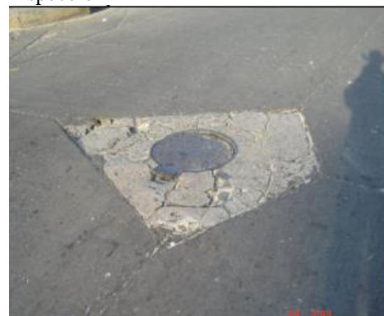
Figura 23. Vista típica Grietas em pozos de inspección
