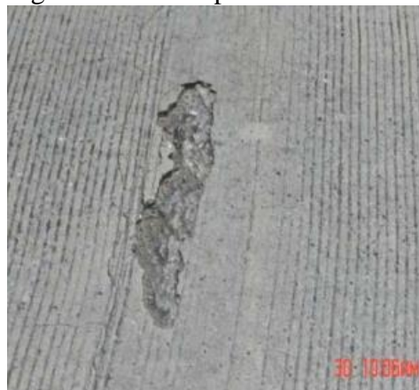
Figura 31. Vista típica Descascaramiento
