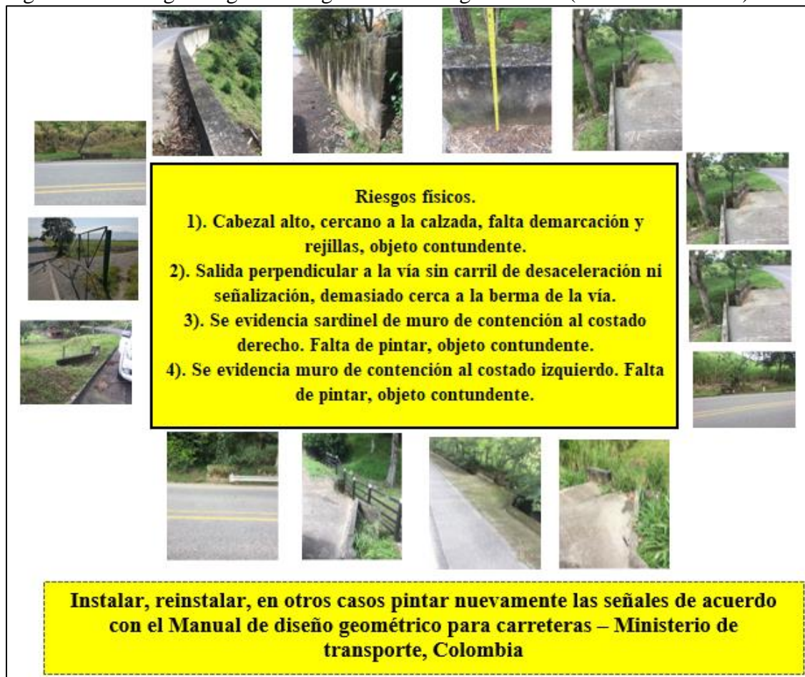
Figura 42. Hallazgos Registro fotográfico de Riesgos físicos. (Recomendaciones)
