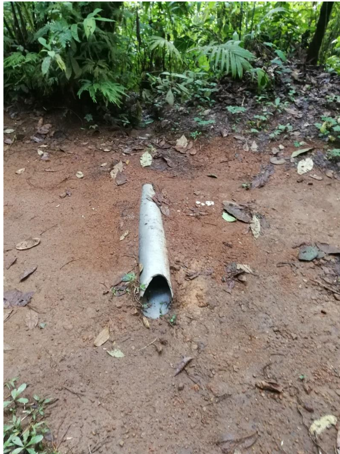
Foto 1 Malas conexiones aguas residuales
