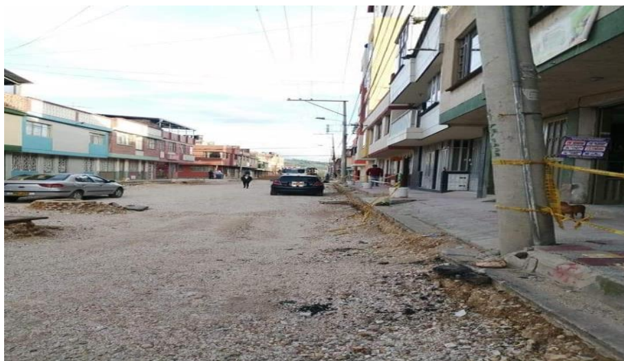
Figura 5, Obras inconclusas por entidades encargadas.
