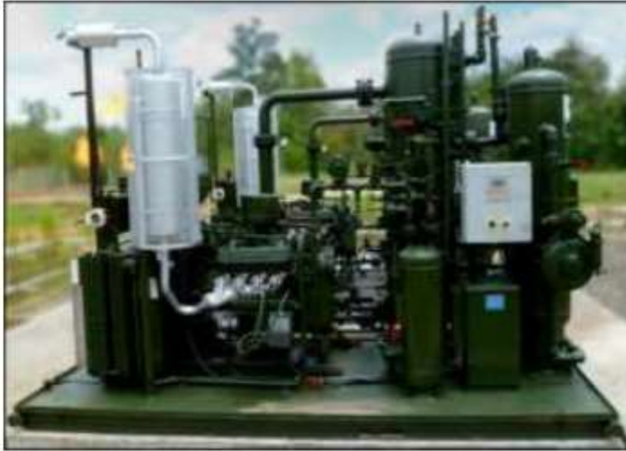
Figura 8. Jack compresor de gas
