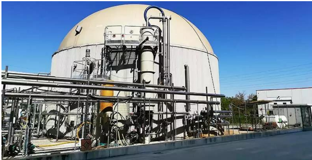
Figura 2 - 10. Tanque Reactor de Mezcla de Flujo Continuo.
