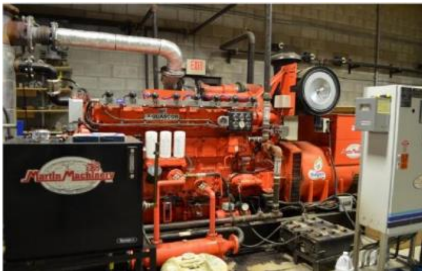
Figura 1 - 8. Generador de electricidad con biogás
