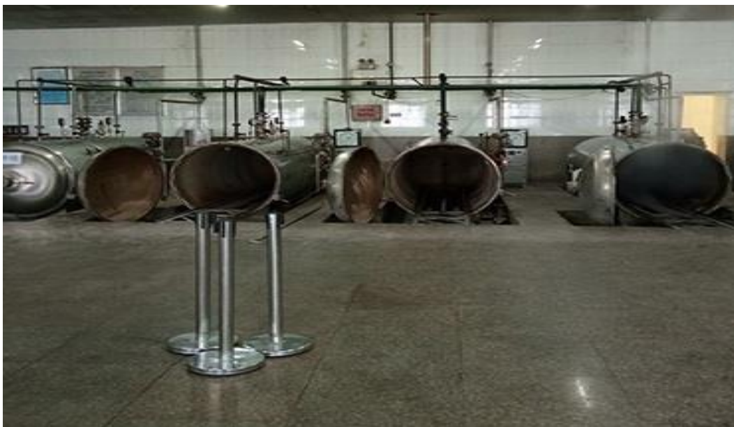
Instalaciones de la Planta
