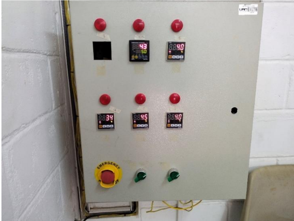
Figura 4 – Tablero PLC para control de temperatura.
