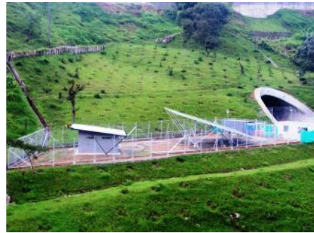
Fotografía 1. Planta energía solar túnel de Santa Rosa
