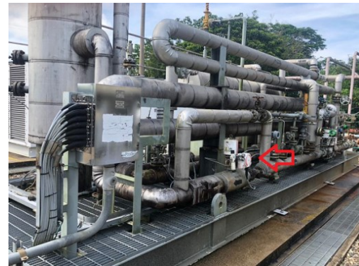
Figura 9. Válvula FISHER instalada en el proceso. Fuente: Planta de gas Sardinata.
