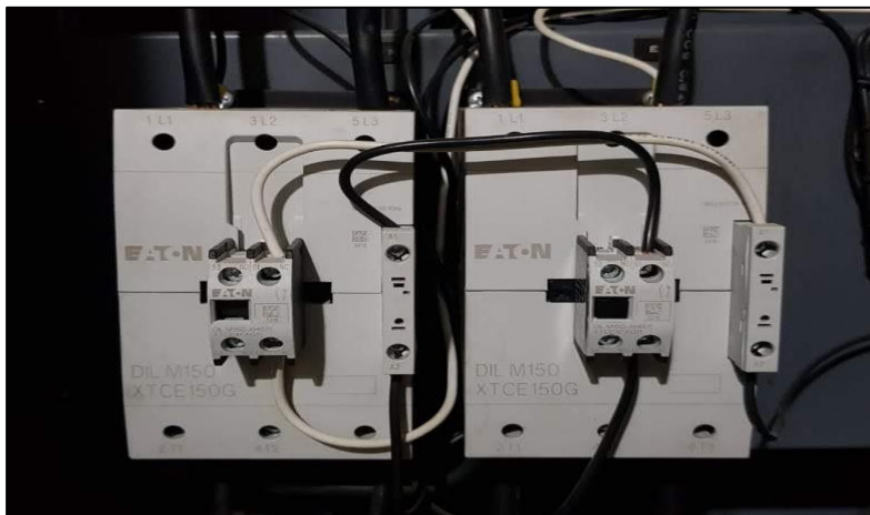
Imagen 4. 3 Contactores para cierre del circuito de energía.
