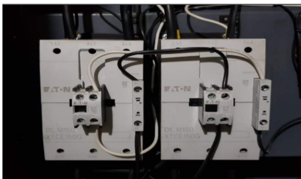
Imagen 4. 3 Contactores para cierre del circuito de energía.
