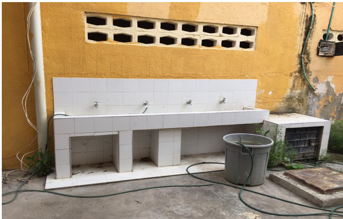
ANEXOS. 1. Zona de lavamanos, alberca subterránea y motobomba de la Institución
