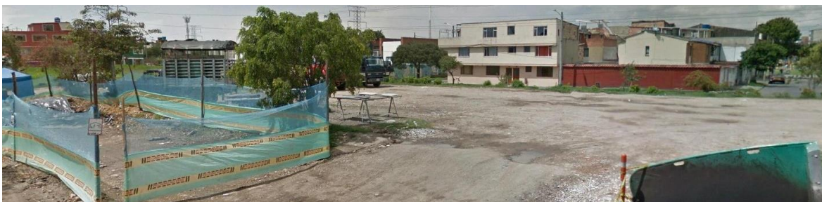
Figura 37 DETERIORO MALLA VIAL Y ESPACIO PÚBLICO
