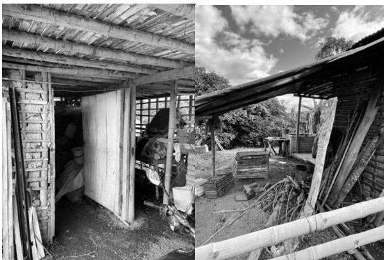
Figura 32. Falencias arquitectónicas en las viviendas de la vereda La Falda
