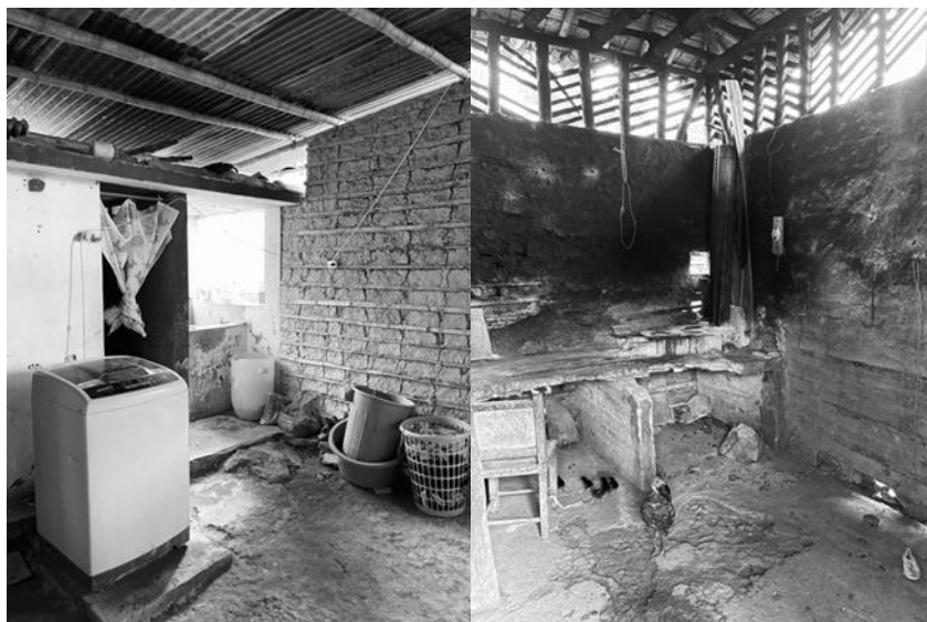
Figura 34. Deficiencias en áreas de servicio en las viviendas de la vereda La Falda.
