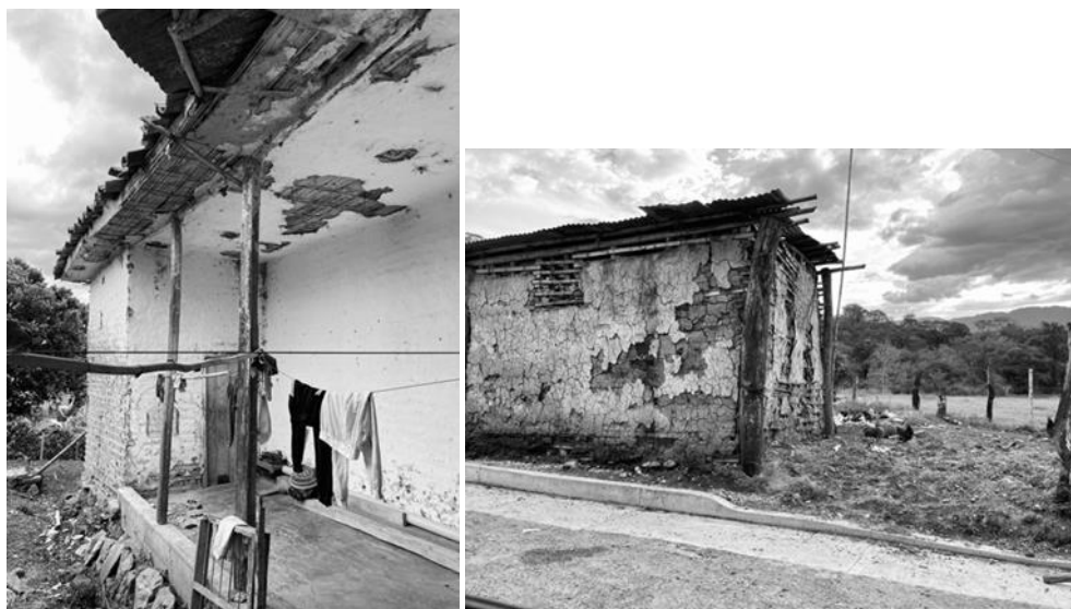
Figura 31. Problemas de estructuras en las viviendas de la vereda La Falda
