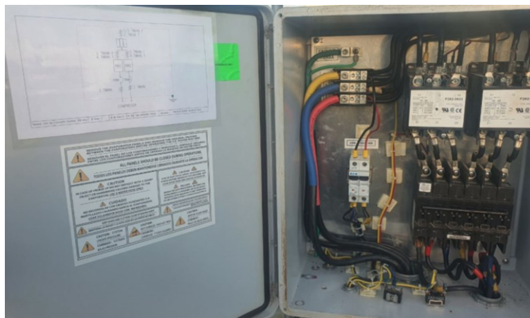
Figura 2-67: Tablero de compresores conectado maquina Hielera.
