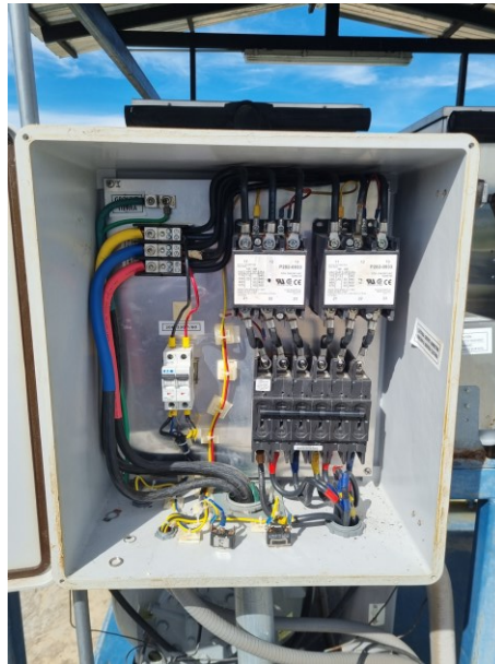
Figura 2-66: Tablero de compresores conectado maquina Hielera.
