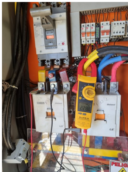
Figura 2-70: Tensión de las líneas L1-L2.
