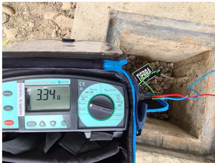
Figura 3-4: Resistencia de puesta a tierra 3.34 ohmios por medio de telurómetro.
