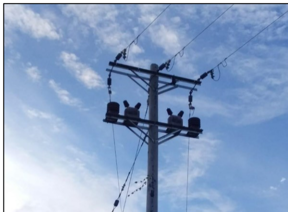
Figura 2-51: Transformador SIEMENS de 150 KVA en estructura H.
