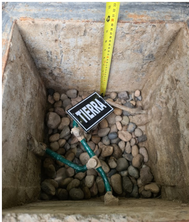
Figura 2-53: Caja de Inspección 30x30cm S.P.T con soldadura exotérmica.
