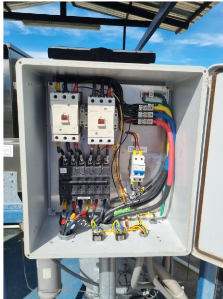
Figura 2-64: Tablero de compresores conectado maquina Hielera.
