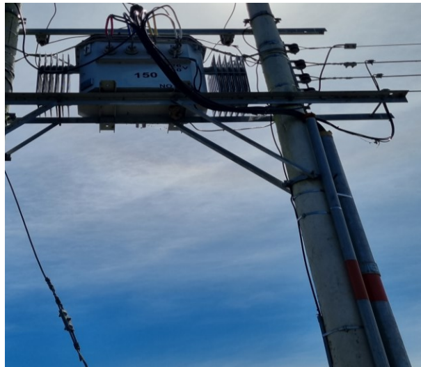
Figura 2-57: Bajante acometida interna del transformador de 150KVA.
