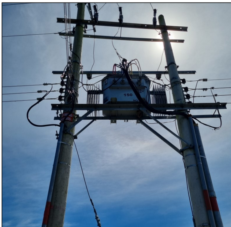
Figura 2-49: Transformador SIEMENS de 150 KVA en estructura H.
