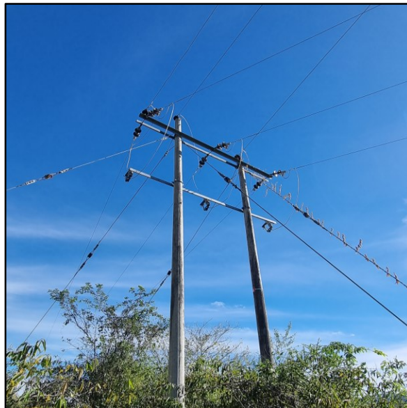
Figura 2-43: Punto de Conexión SAN ALFONSO media tensión.
