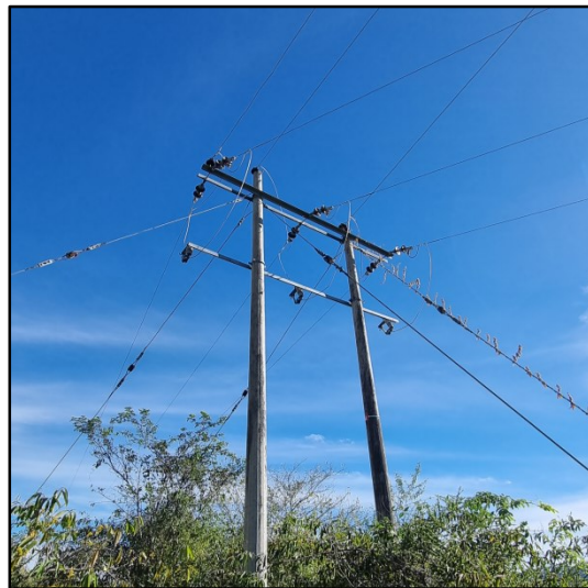
Figura 3-5: Punto de conexión SAN ALFONSO red media tensión.
