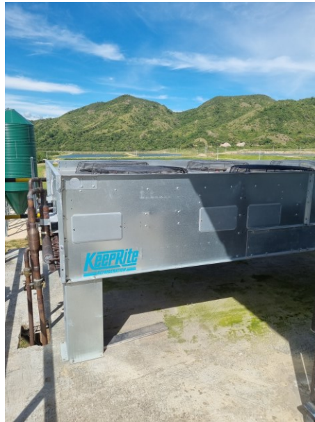
Figura 2-60: Ventiladores máquina Hielera AV400CR.
