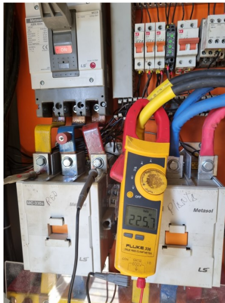
Figura 3-1: Medida baja tensión 225.7 Voltios.
