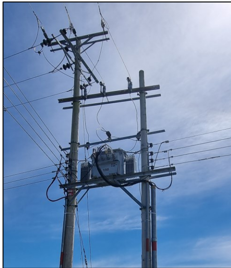
Figura 2-50: Transformador SIEMENS de 150 KVA en estructura H.
