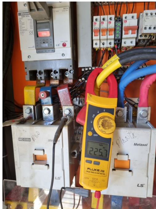
Figura 2-68: Tensión de las líneas L1-L3.
