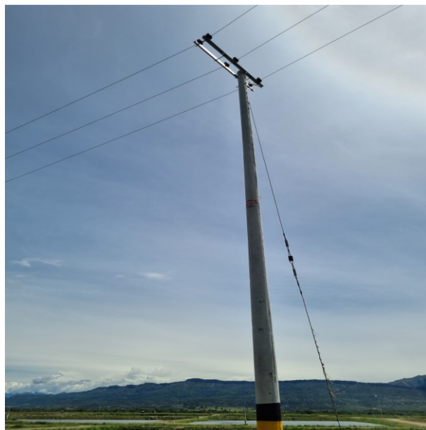
Figura 2-45: Estructura de paso para red de media tensión.
