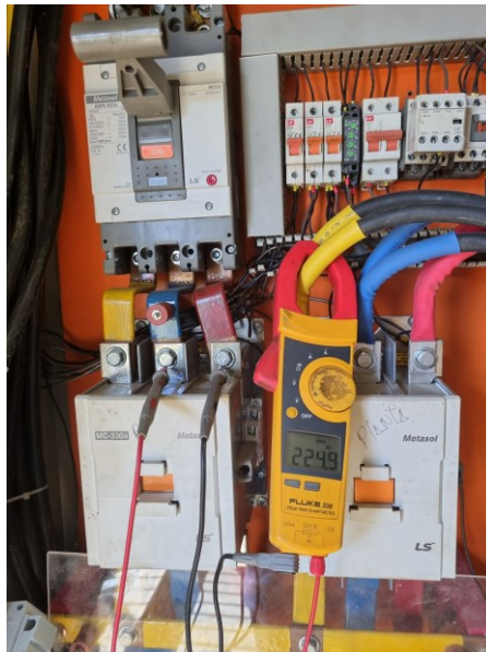
Figura 2-69: Tensión de las líneas L2-L3.
