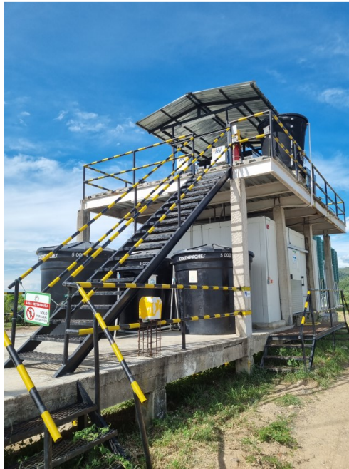
Figura 2-58: Plataforma para máquina hielera y cuarto frío.
