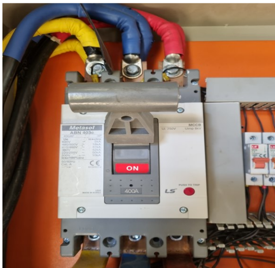
Figura 2-55: Tablero de distribución principal.
