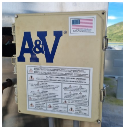
Figura 2-63: Tablero compresores maquina Hielera.
