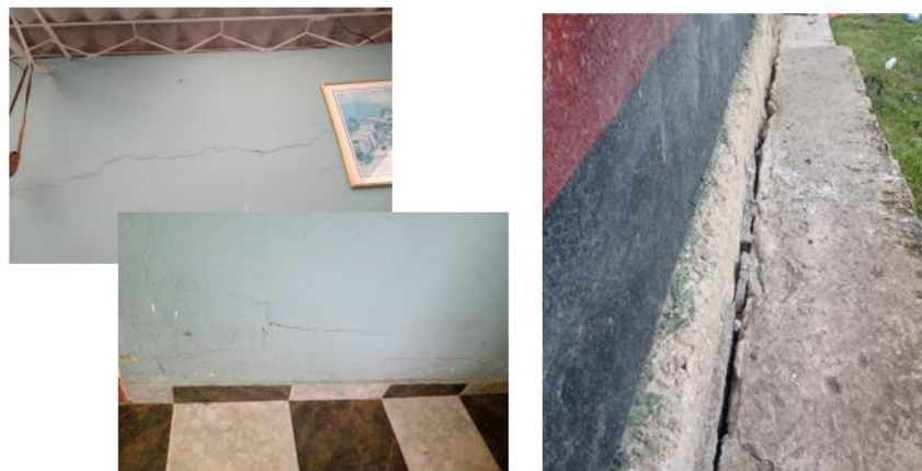
Ilustración 1: Registro fotográfico de grietas en viviendas de la vereda Timasita.
