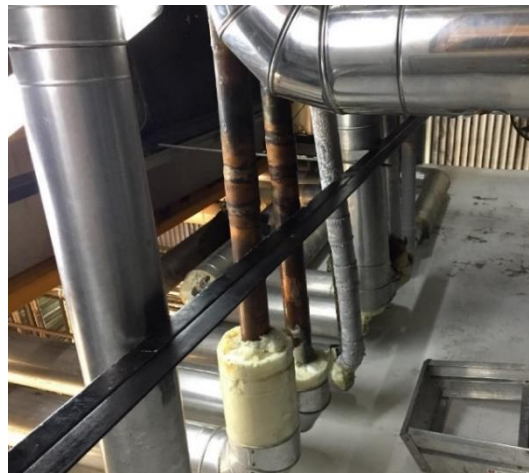
Figura 16 Aislamiento de tuberías del sistema de refrigeración y congelación
