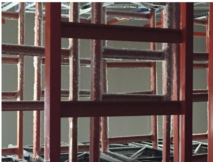
Figura 11 Hielo formado dentro del sistema de refrigeración
