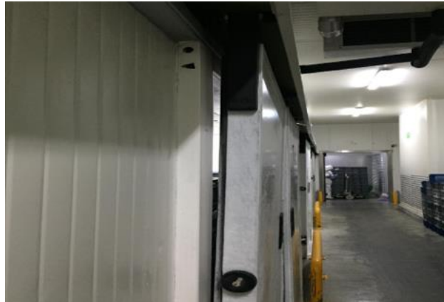
Figura 17 Puertas de filtrado de aire
