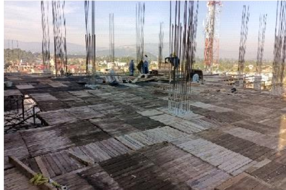
Descripción: Instalacion de camilla
