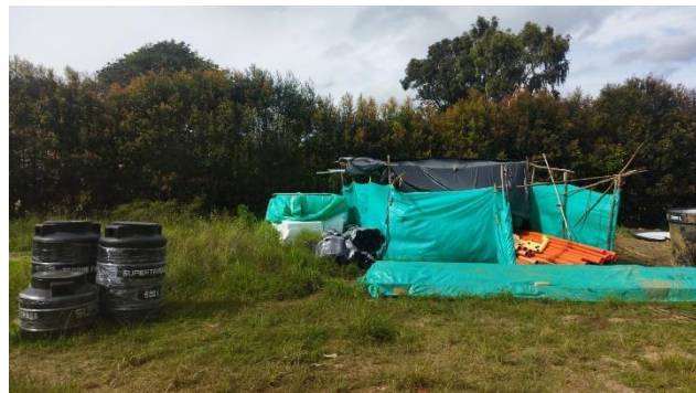
Rosetón para los tanques anaeróbicos y tubería
