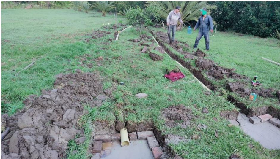
Canal a los Pozos Sépticos
