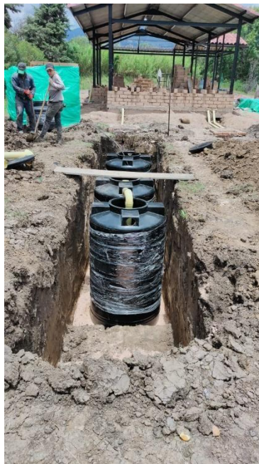
Pozo séptico y caja de inspección
