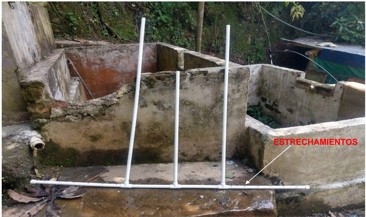
Figura 20 Estrechamientos (Agujeros en los tubos)
