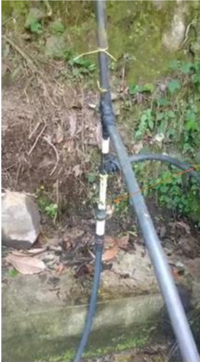
Figura 22 Llave de paso en el sistema de aireación
