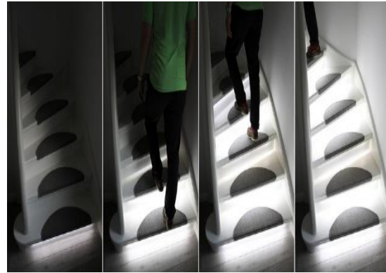
Imagen 11: iluminación inteligente escaleras.
