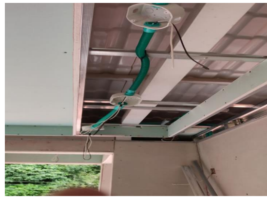
Foto 7: Alambrado puntos de iluminación.
