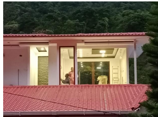
Foto 16: prueba de iluminación.
