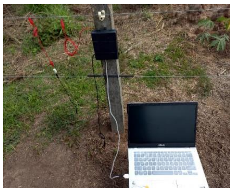
Figura 4.13 Recoleccion datos cerca en falla mala
