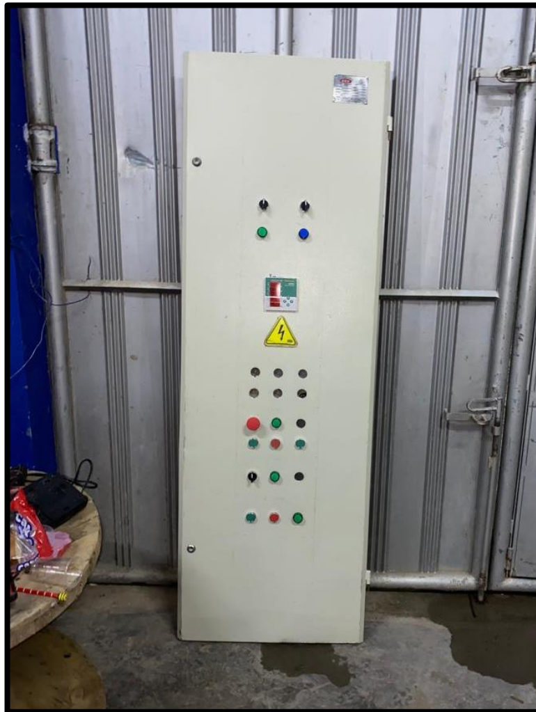
Figura 21 Armario metálico base para el tablero
