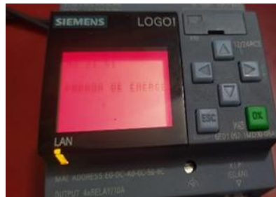
Fig. 16. Pantalla PLC parada de emergencia
