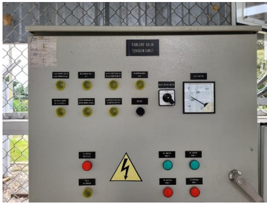
Imagen 4 exterior tablero Instrumentacion y control – imagen propia
