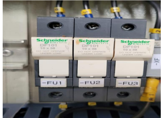
Imagen 12 Fusible- imagen propia
