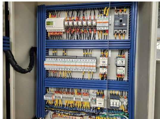
Imagen 3 interior tablero instrumentacion-control, imagen propia
