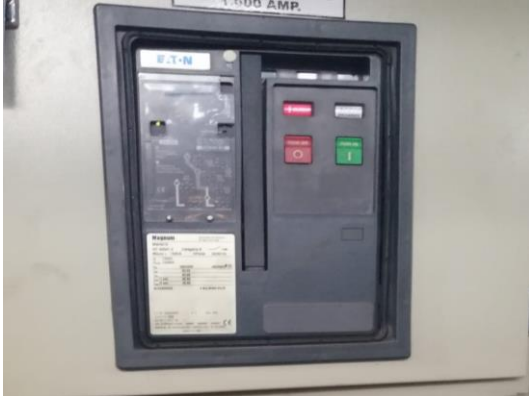
Imagen 6 interruptor motorizado, imagen propia
