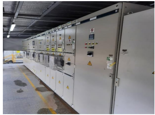
Imagen 1 Tablero de control VSD- imagen propia
