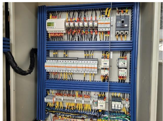
Imagen 3 interior tablero instrumentacion-control, imagen propia
