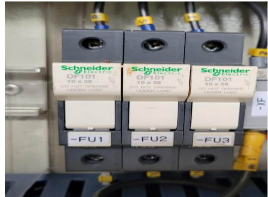
Imagen 12 Fusible- imagen propia
