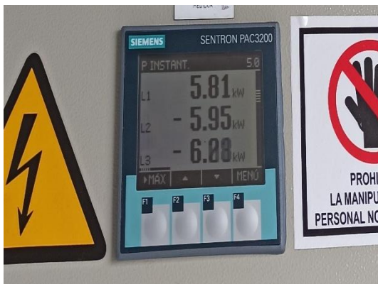
Imagen 7 medidor general, imagen propia
