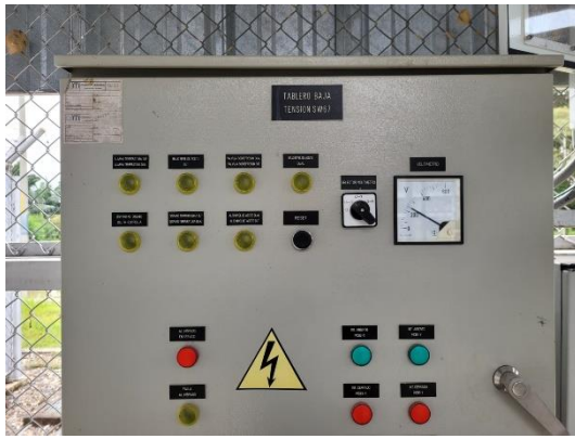
Imagen 4 exterior tablero Instrumentacion y control – imagen propia
