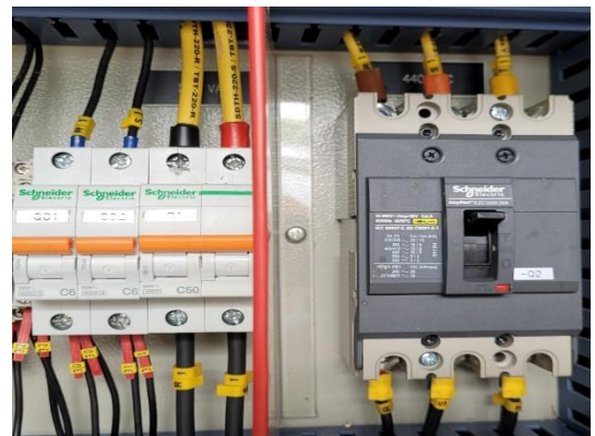
Imagen 9 Interruptor termomagnético- Imagen propia
