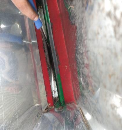
Figura anexo 10: revision del alimentador en buen estado
