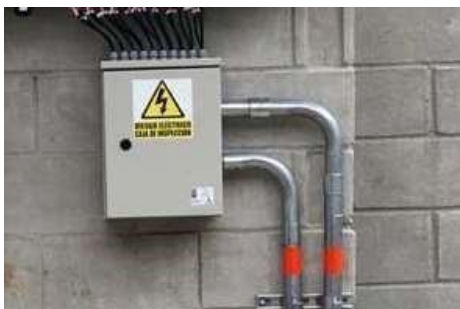
Figura 15: Señalización de símbolo de riesgo eléctrico
