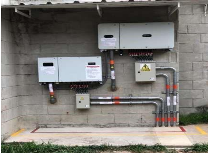
Figura 16: Instalación con dictamen conforme
