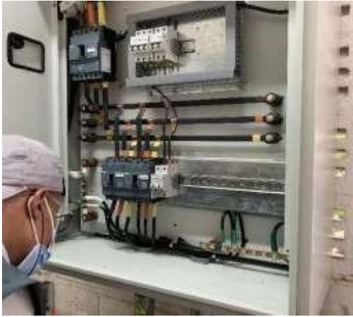
Figura 16: Tablero de protección.
