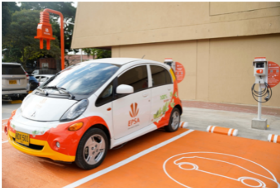
Figura 44. Estaciones de servicio de carga eléctrica en Medellín. Celsia.
