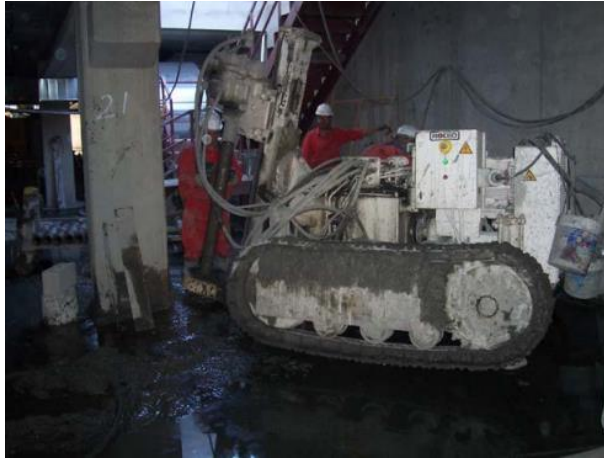
Figura 27. Máquina Utilizada En La Ejecución De Los Micropilotes Para Recalces, Trabajando En El Sótano De Una Nave Industrial En Villaverde (Madrid)
