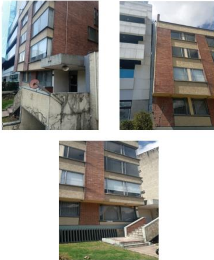
Figura 30. Patologías Edificio Av. 100
