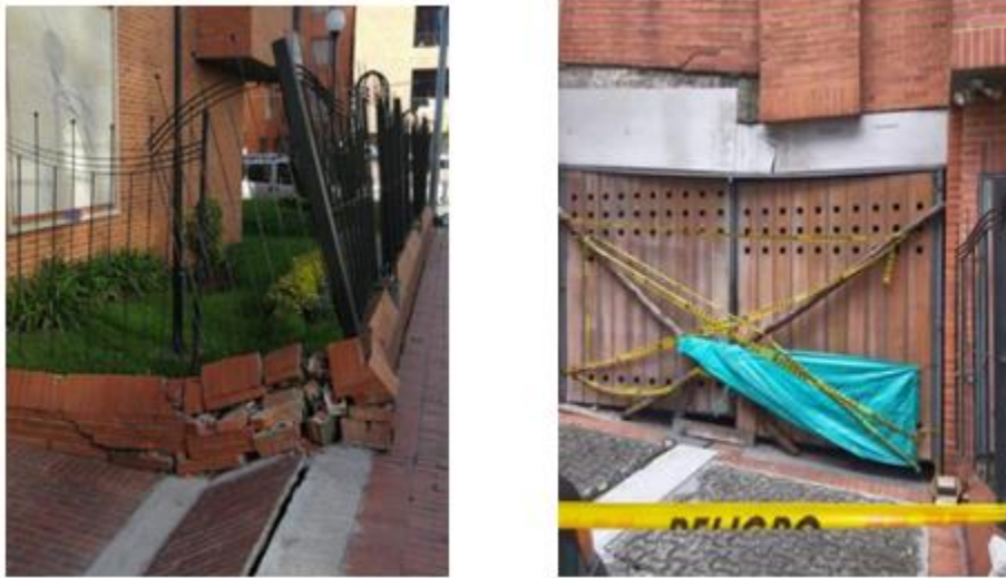
Figura 19. Patología Estructural Presentada en el Edificio Manglar
