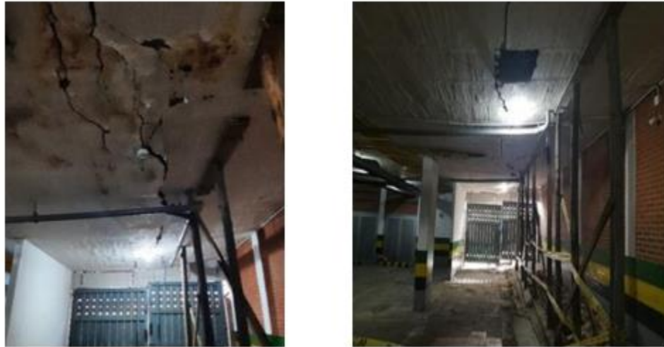
Figura 21. Patología Estructural Presentada en el Edificio Manglar
