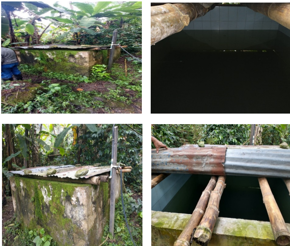
Imagen 7 Tanque de distribución.
