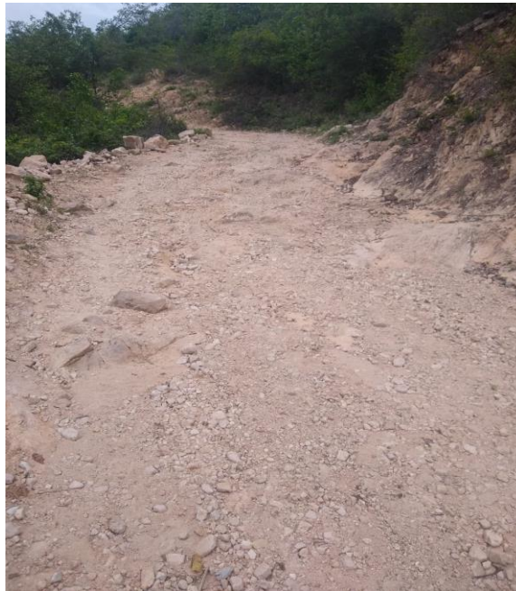
Fotografía 10. Deterioro por pérdida de agregado
