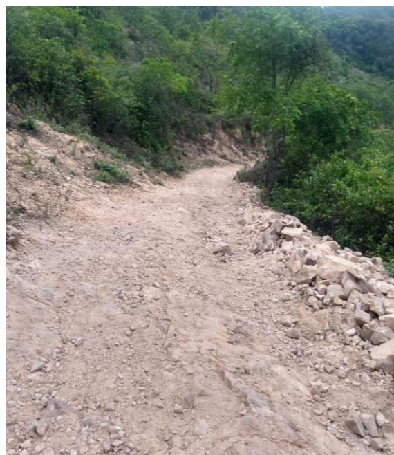
Fotografía 12. Deterioro por sección transversal inadecuada y pérdida de agregado
