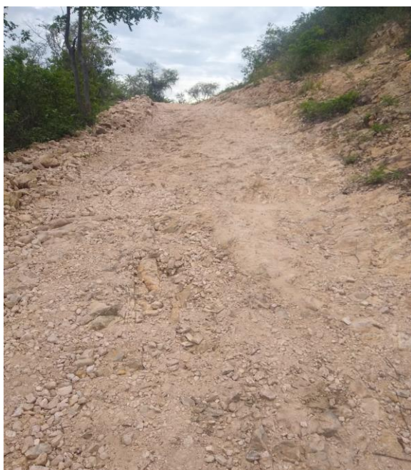
Fotografía 11. Deterioro por pérdida de agregado
