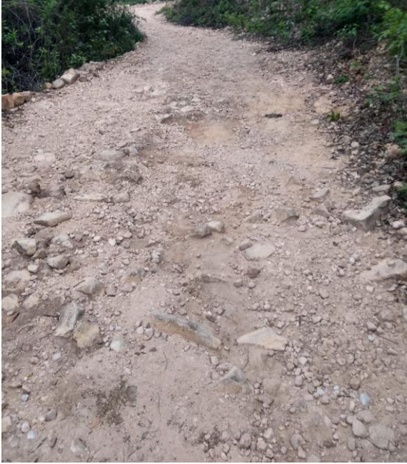
Fotografía 13. Deterioro por perdida de agregado
