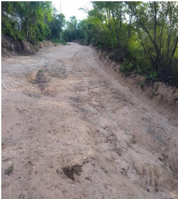
Fotografía 9. Deterioro por sección transversal inadecuada y pérdida de agregado
