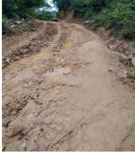
Fotografía 14. Deterioro por ahuellamiento y perdida de agregado
