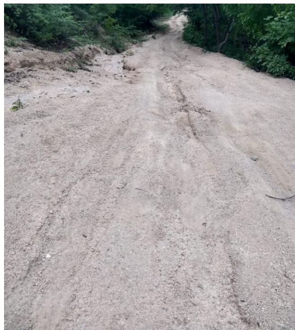
Fotografía 7. Deterioro por ahuellamiento y pérdida de agregado
