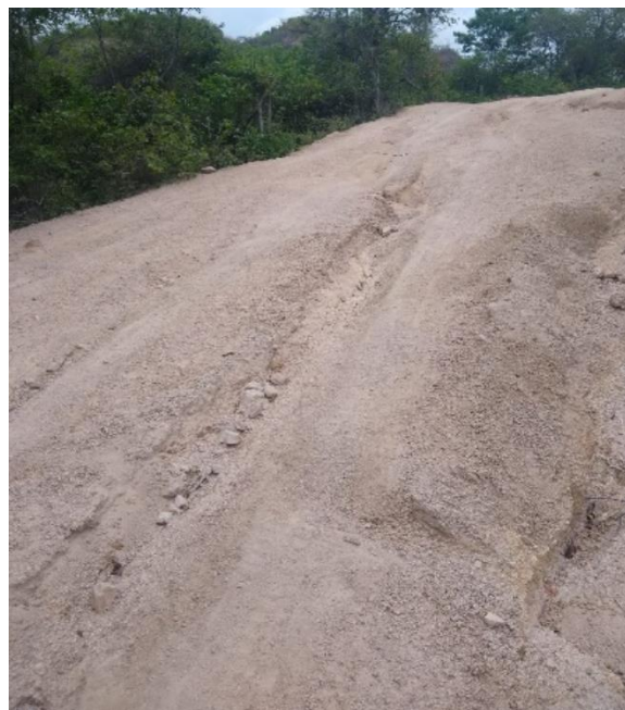
Fotografía 8. Deterioro por pérdida de agregado
