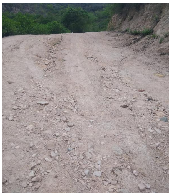
Fotografía 6. Deterioro por pérdida de agregado
