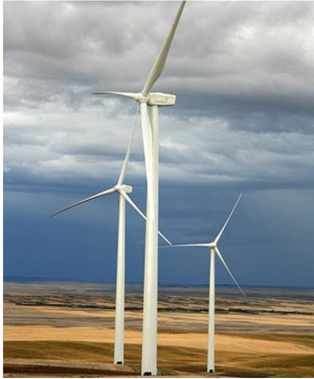
Figura 2. Aerogenerador de eje horizontal. Fuente: [2]
